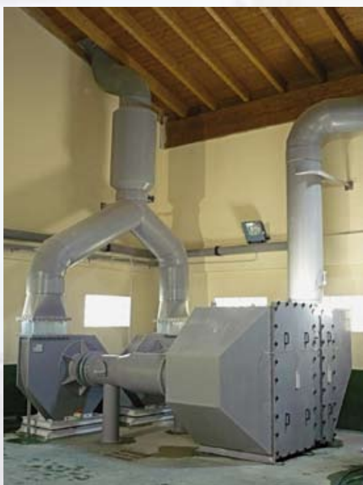
Desodorización por Equipo compacto de Carbón Activo con doble etapa, Q=9.200 \text{ m}^3/\text{h} .
