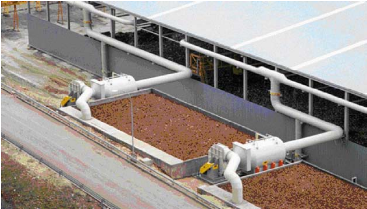
Instalaciones de Desodorización por Biofiltración, Q=72.000 m 3 /h y Q=50.000 m 3 /h; planta tratamiento RSU.
