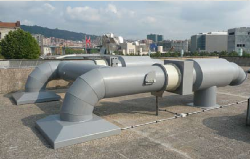
Instalación Desodorización y Ventilación Q=18.100 \text{ m}^3/\text{h} .
